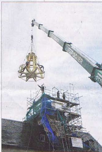
Per Kran wird die sanierte Turmhaube auf die Remptendorfer Kirche aufgesetzt. Foto: Stefan Schreier
